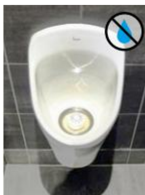
Figure 8 : Urinoir sec (Source : réseau OCAP)
